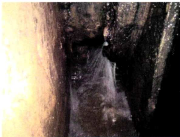
รูปที่ ๕ Guard Gate เกิดการรั่วและมีน้ำไหลพุ่งออกมา
