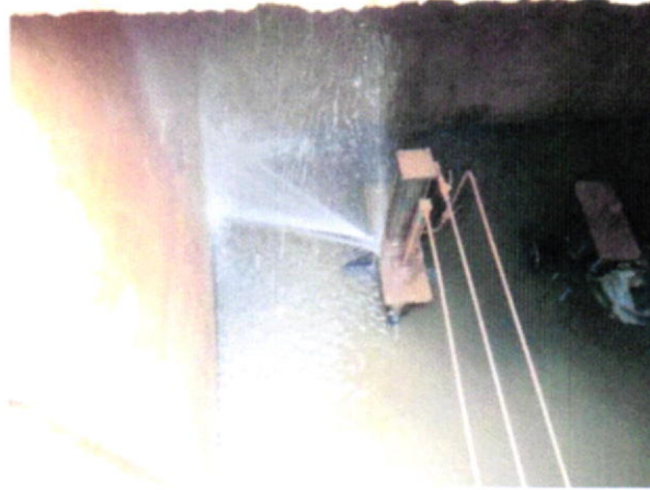
รูปที่ ๒ Operating Gate เกิดการรั่วและมีน้ำไหลพุ่งออกมา
