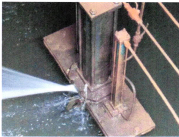
รูปที่ ๓ Operating Gate เกิดการรั่วและมีน้ำไหลพุ่งออกมา
